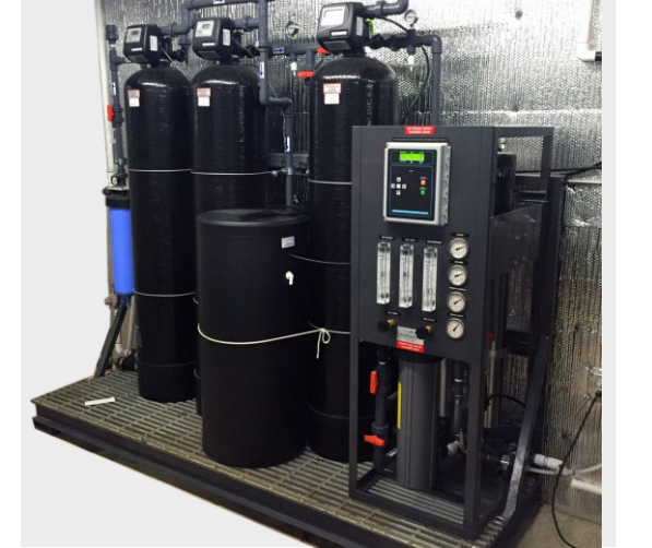
"Merkezi İçme Suyu Arıtma Ünitesi"
